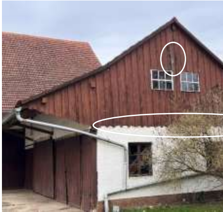
Abbildung 15: Pot. Spaltenstrukturen unterhalb und an Holzfassaden an dem alten landwirtschaftl. Lagergebäude (C).
