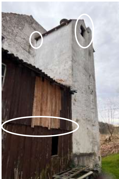
Abbildung 17: Pot. Spaltenstrukturen an Holzfassaden und am Mauerwerk sowie nachgewiesene Ausflugsöffnung an Gebäude A.
