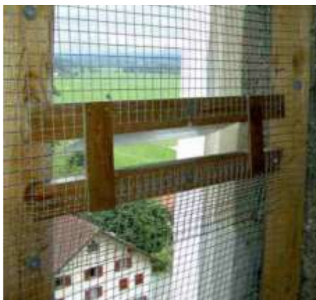
Abbildung 5: Spalt in engmaschig vergittertem Fenster mit schrägem Blech zum Schutz vor Tauben (aus Koordinationsstellen für Fledermausschutz Südbayern, 2020b).
