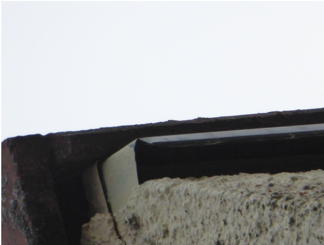
Abbildung 5: Spalten zwischen Mauerkrone, Attikablech und Dachziegeln mit Potenzial für Fledermausquartiere oder Vogelnester.
