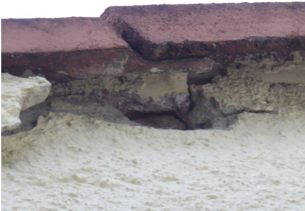
Abbildung 6: Bauschäden an der Fassade können bei tiefer gehenden Spalten bzw. Hohlräumen als potenzielles Fledermausquartier dienen.
